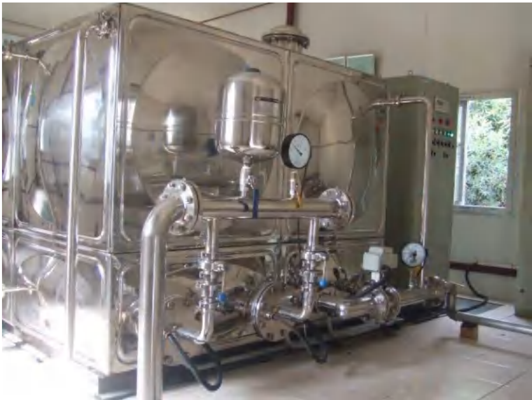
ZWL(III)水箱式静音无负压现场图
